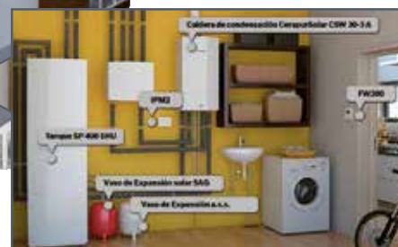
Los sistemas solares se pueden combinar con diferentes tecnologías para apoyo en la producción de calefacción como las bombas de calor.
